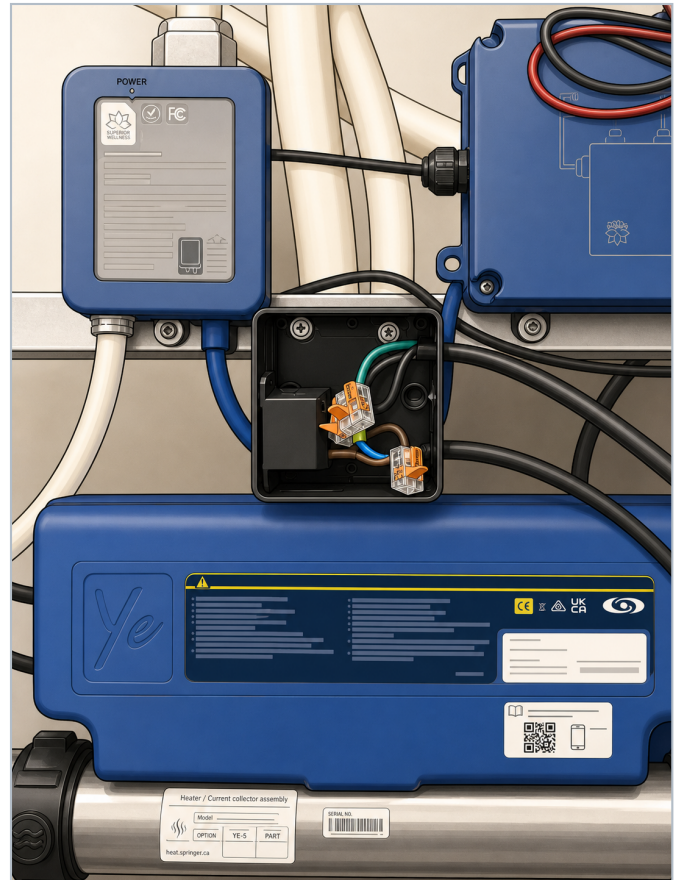
Kuvassa kytkentä on valmiina.
